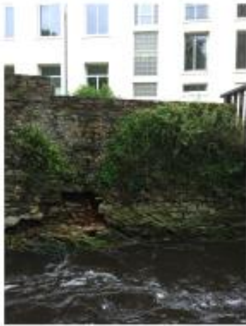
9P Photo n°2 – érosion des berges au confluent du Rollard et du bras sud de la Chère
